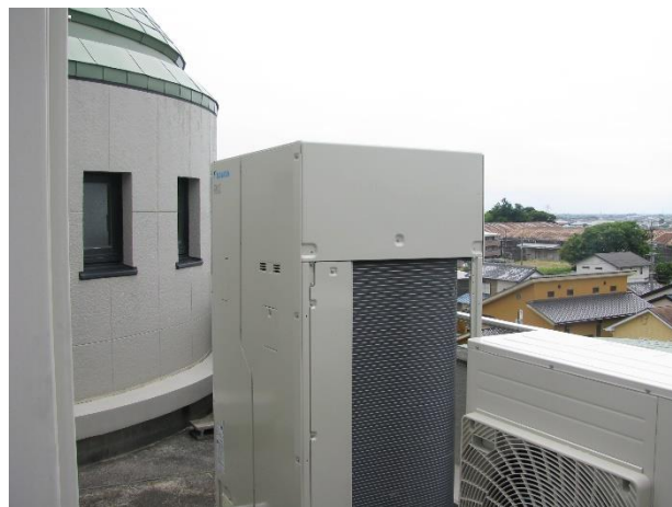
屋上に設置された室外機
