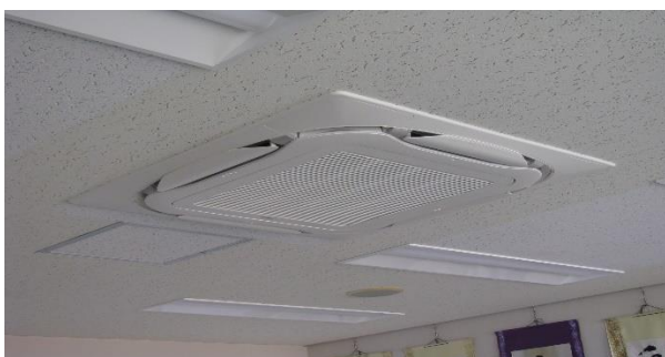
相談室エアコン(更新後)
