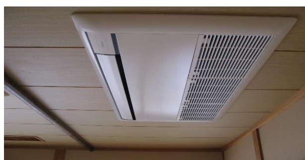
生涯学習室エアコン(更新後)
