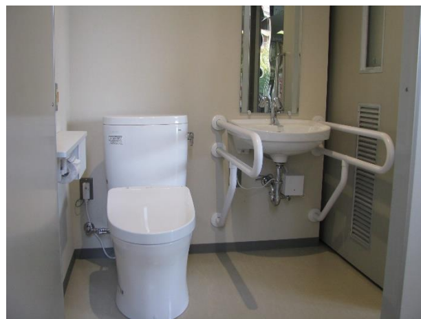
バリアフリートイレ個室
