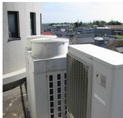
屋上にある室外機
