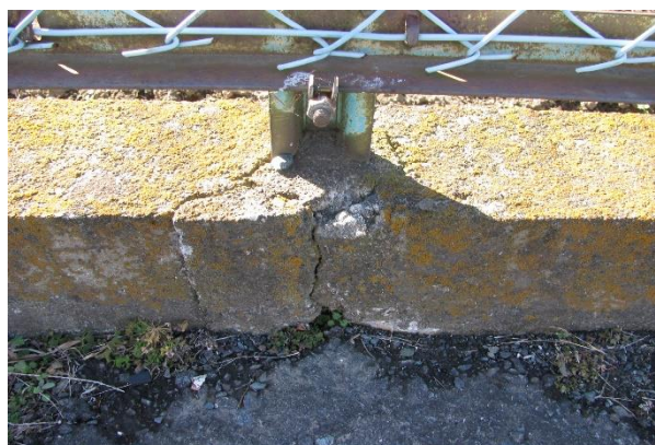
支柱根元（基礎のひび割れ）
